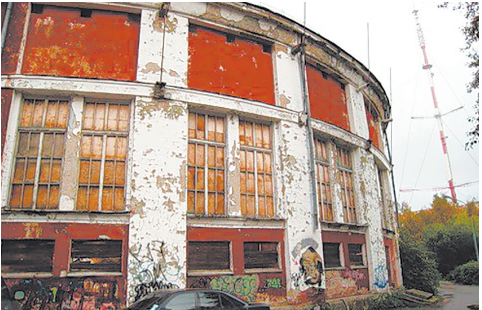
Время не пощадило здание ни внутри, ни снаружи
